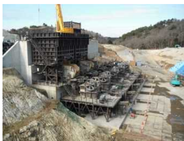
写真-2 破砕設備
