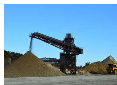
写真-4 巡回コンベヤ
