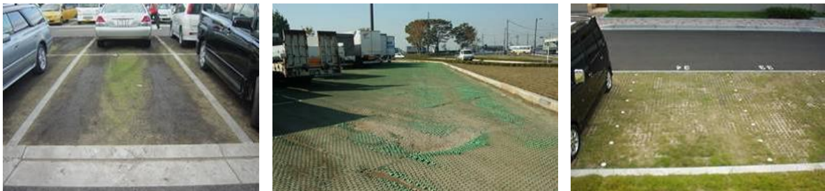
図-1 芝生が枯損した駐車場緑化の事例 1)
