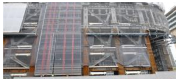
写真 3 ダンパー取付状況(建設中の外観: 白い水平部材が高減衰オイルダンパー)
